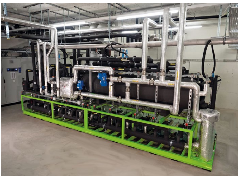
CO 2 -Booster-Kälteanlage mit Ejektoren und Parallelverdichtern.
