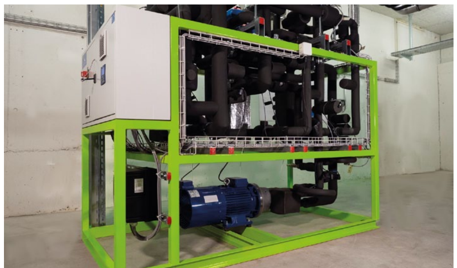
Das Energie-Transfer-System der Prodega Dietikon ist seit Herbst in Betrieb.
